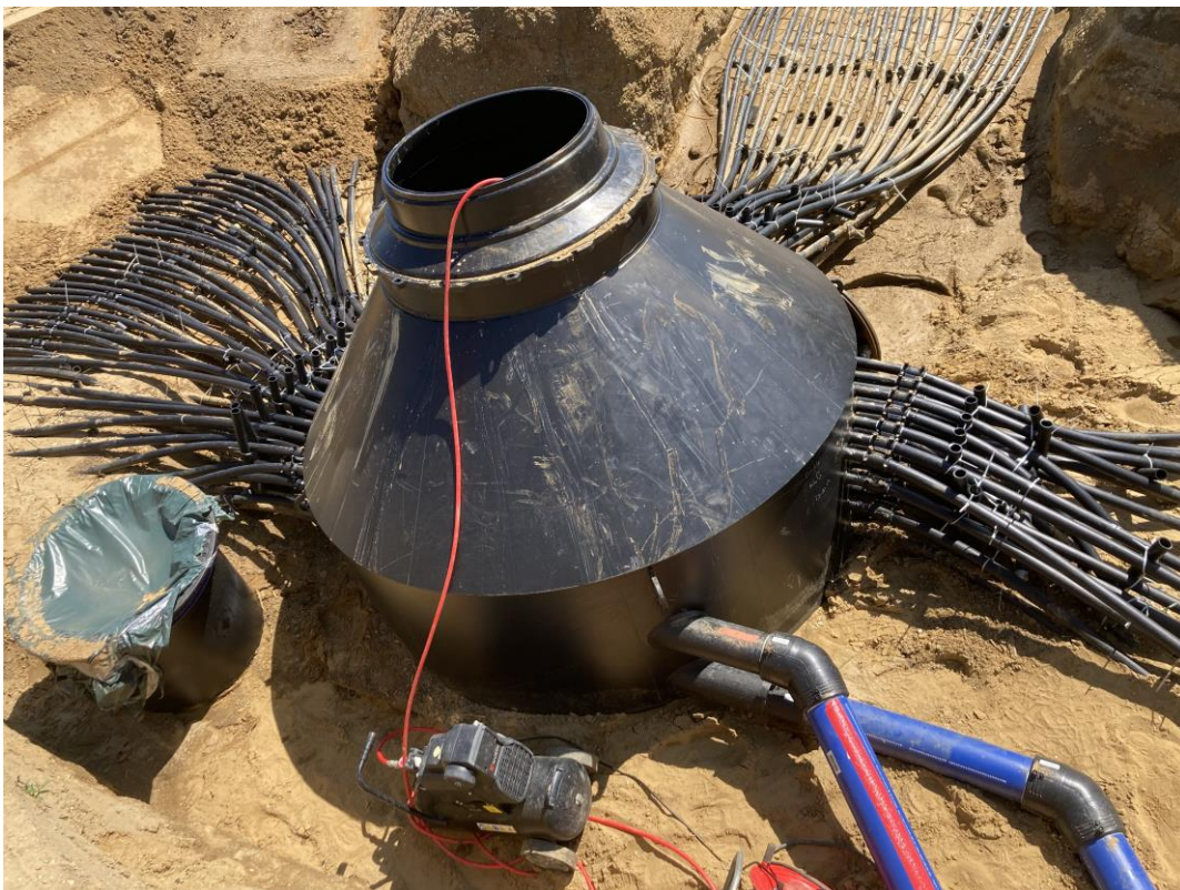
Übergabe Sondenfeld an Hauptleitung Netz
